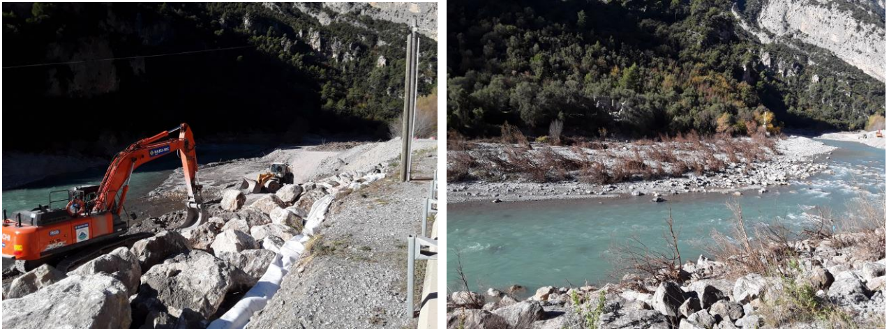
Confortement de la berge et restauration des enrochements (photo de gauche) et berge impactée (Photo de droite) après le passage de la crue
